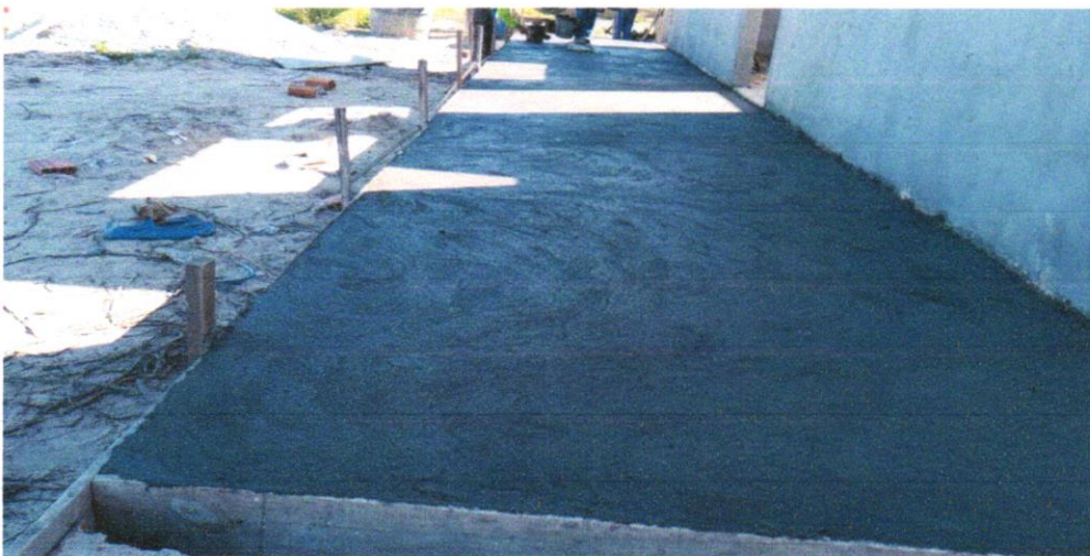
FOTO 22 - EXECUÇÃO DE PASSEIO (CALÇADA) OU PISO DE CONCRETO COM CONCRETO MOLDADO IN LOCO, USINADO, ACABAMENTO CONVENCIONAL, NÃO ARMADO. AF_07/2016
