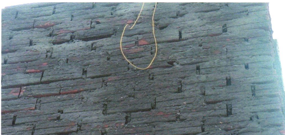
FOTO 02 - CHAPISCO APLICADO EM ALVENARIAS E ESTRUTURAS DE CONCRETO INTERNAS, COM COLHER DE PEDREIRO. ARGAMASSA TRAÇO 1:3 COM PREPARO EM BETONEIRA 400L.
