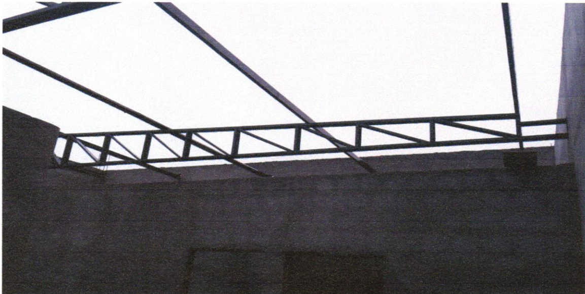
FOTO 06 – TRAMA DE AÇO COMPOSTA POR TERÇAS PARA TELHADOS DE ATÉ 2 ÁGUAS PARA TELHA ONDULADA DE FIBROCIMENTO, METÁLICA, PLÁSTICA OU TERMOACÚSTICA, INCLUSO TRANSPORTE VERTICAL. AF_07/2019
